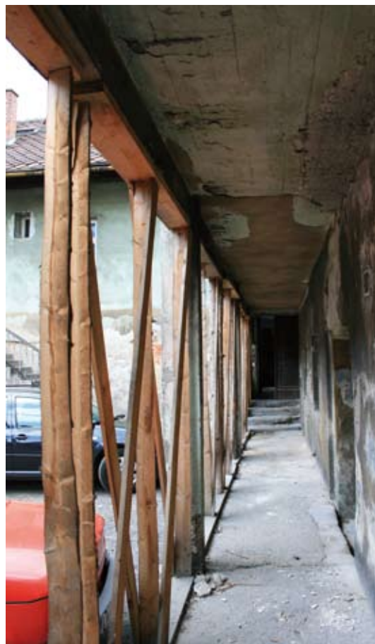
Jest coraz mniej czasu na ratowanie tej kamienicy
